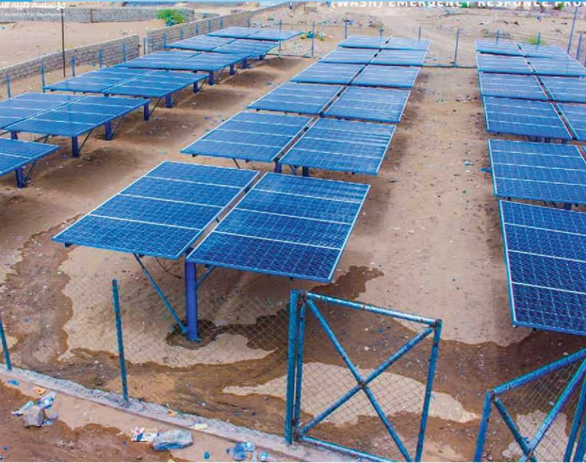
Solar energy system to operate the project منظومة لطاقة الشمسية لتشغيل المشروع
